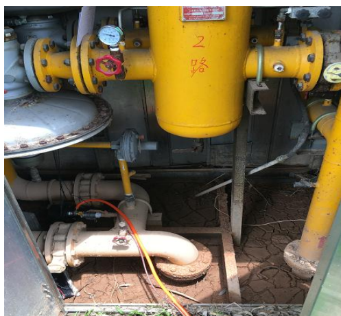
图 2-5 调压箱低压放散口
